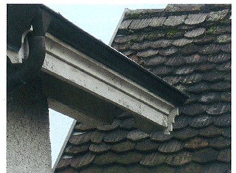
Les sous-faces de toits sont souvent délaissées lors de rénovations. Un manquement qui peut entraîner des frais importants, car ces zones sont difficiles d'accès.
