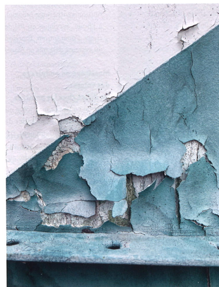
Exemples type de supports présentant beaucoup de problèmes : farinage du film de peinture, épaisseurs trop importantes de peinture : écaillage, craquelures et moisissures
