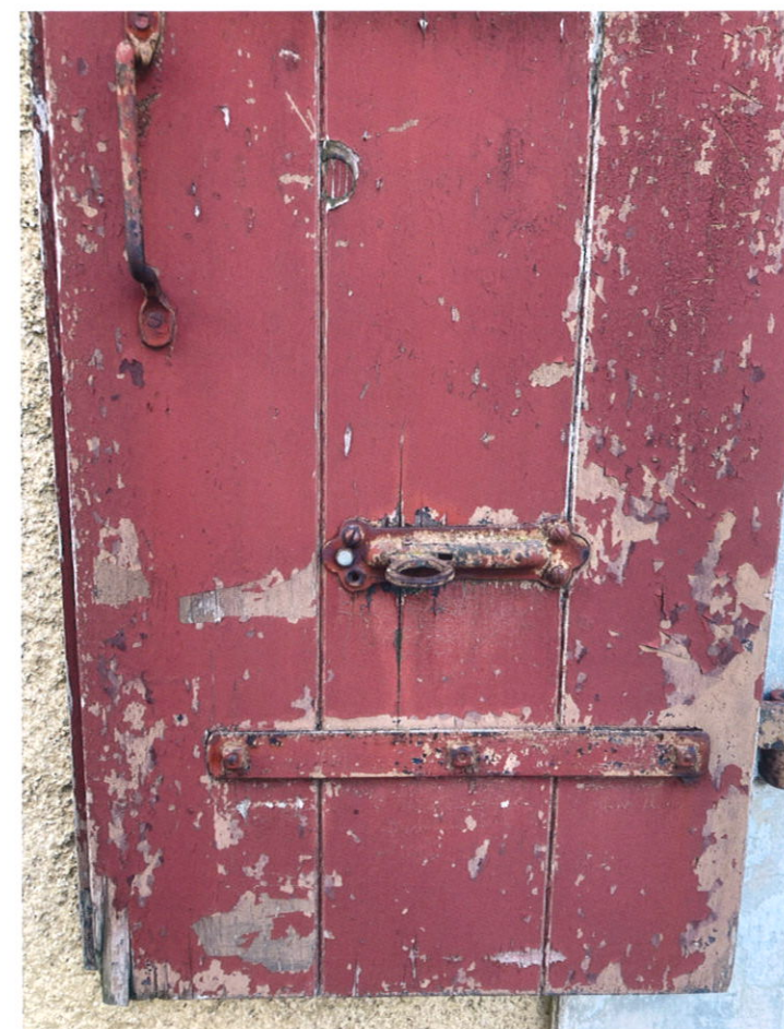
Avant rénovation : en très mauvais état
